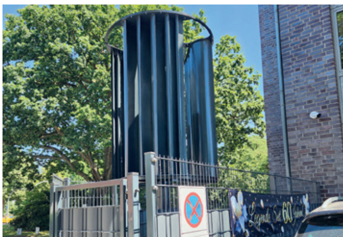
Die inzwischen installierte, große Windkraftanlage mit der „Langenhorner Friedenseiche“ im Hintergrund.
